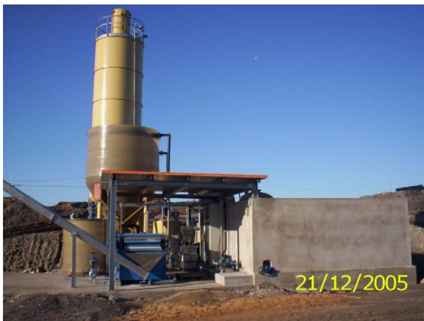
Fotografia 7: Impianto di trattamento delle acque di drenaggio della discarica
